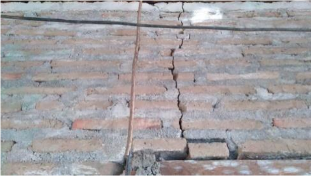
Gambar 4. Retakan dinding rumah warga Padukuhan Karang
