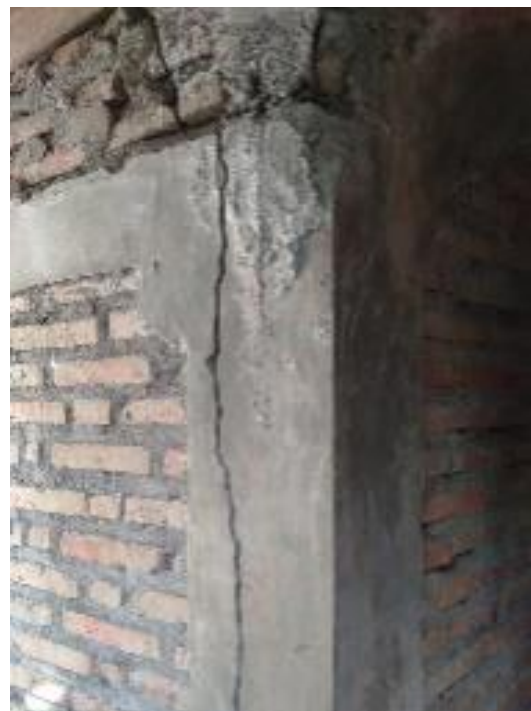
Gambar 3. Struktur kolom dan dinding bata yang terbelah
