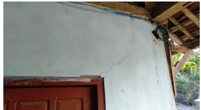
Gambar 1. Retakan dinding area void di Balai Karang
