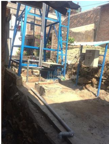
Gambar 5. Instalasi Jaringan Listrik
