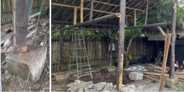
Gambar 6. Kondisi Tiang/Kolom Bambu yang Miring (Dokumentasi Penulis, 2025)
