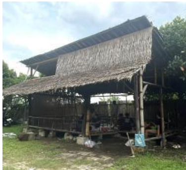
Gambar 3. Kerusakan Balai Bambu (Dokumentasi Panitia Sepekan Arsitektur, 2025)
