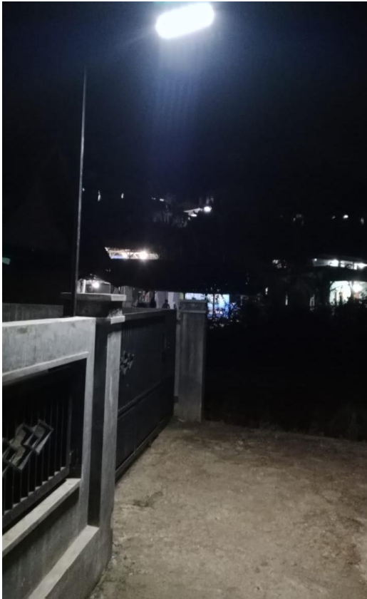
Gambar 7. Lampu penerangan tenaga surya yang dipasang telah berfungsi dengan baik
