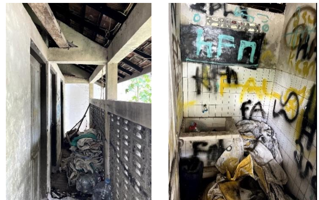
Gambar 2. Kondisi Eksisting Toilet Lama
