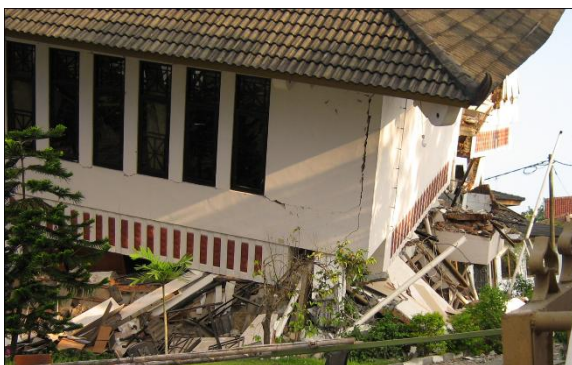
Gambar 5. Kerusakan Bangunan saat Gempa Yogya 2006
