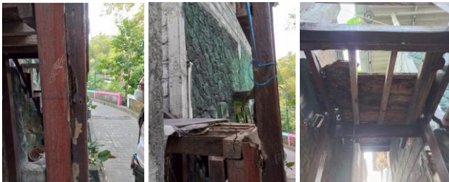
Gambar 4. Detail kerusakan-kerusakan tangga kayu
