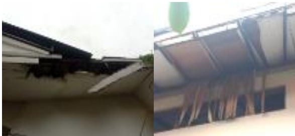
Gambar 1. Kerusakan pada Bangunan Gedung di Fakultas Teknik UPR
