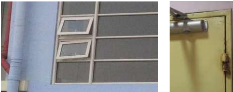
Gambar 8. Kerusakan pada Jendela dan Engsel Pintu
