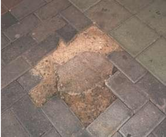
Gambar 9. Kerusakan Paving Block
