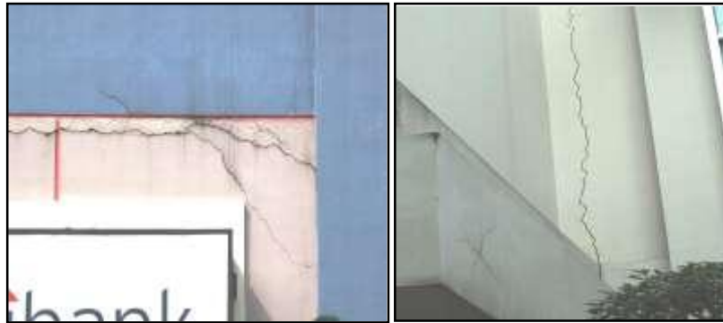
Gambar 7. Retakan pada Dinding
