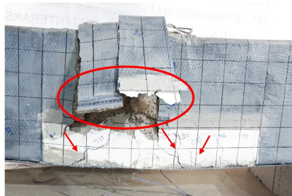
Gambar 10. Kegagalan spesimen balok dengan angkur epoksi
