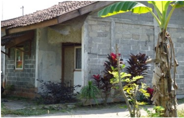
Gambar-7. Rumah di permukiman relokasi yang dibiarkan rusak (Dok. Peneliti, Juni 2011)
