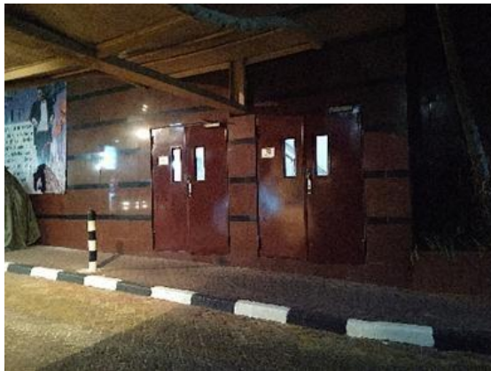
Gambar 10. Pintu Darurat Terhubung Keluar
